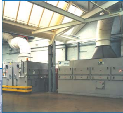
Transferstraßen-Absaugung Volumen: 70.000 Bm³/h
